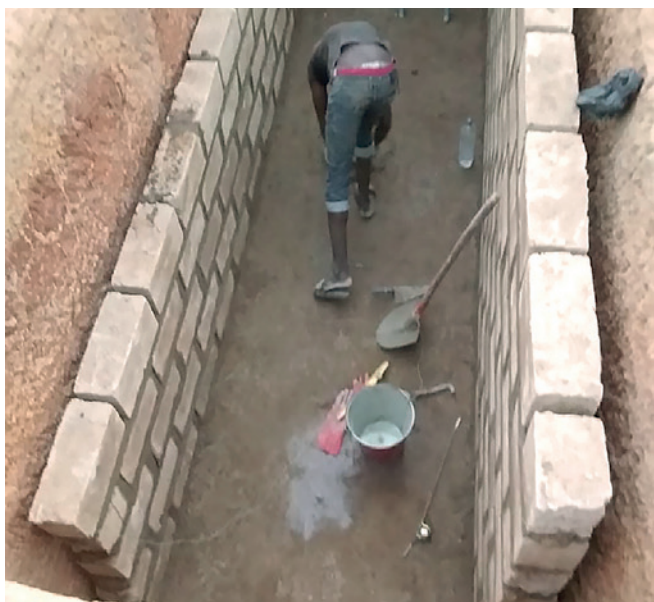
La fosse sous les 4 latrines (2 pour les hommes, 2 pour les femmes)
